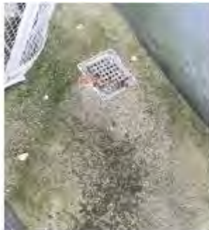
Bagfald på beløntæk ved gulvaflob udvendig trappeskakt til kælder.
