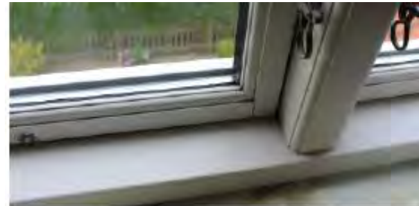
Vindue på første sal, spor efter kondensvand og skimmel på glaslisterne og på gummlisterne.
