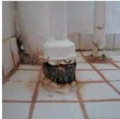
Tæret bøsningrør ved gulv.
