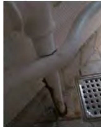
Tæret vandrør i WC på 1. sal.
