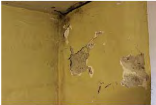
Afskallet ouds og skimmelsvamp på kældervæg.
