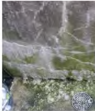
Støttevæggen på kælderskanten har mange revner og har tydelige tegn på at der er vand, som siver i gennem
