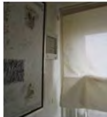
Kanalventilator i WC/bad på 1.sal,
