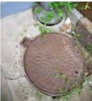
Afløb slutter ikke tæt til regnvand-
