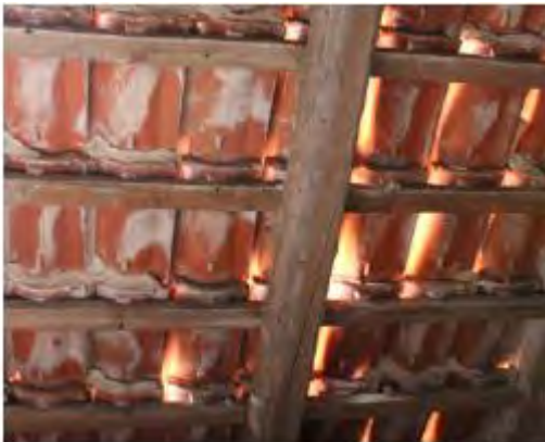
Store udfald af understrygningsmørtel, Bent Grubbesvej
